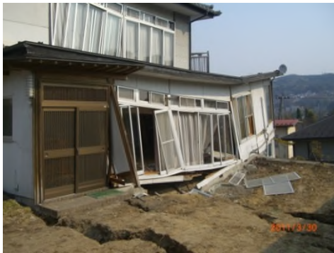
大規模盛土造成地の地震被害例
