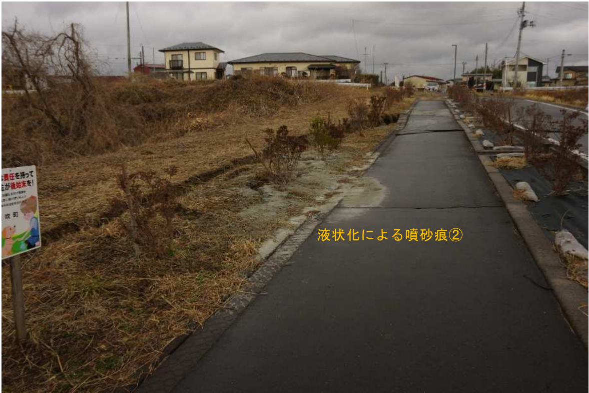
亀裂を伴う段差と亀裂からの噴砂痕
