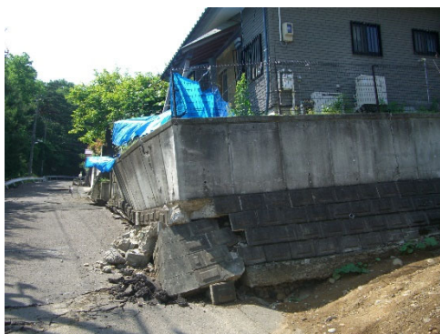
大規模盛土造成地の滑動崩落例
