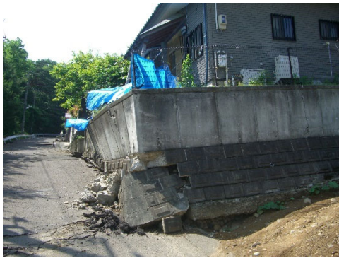
大規模盛土造成地の滑動崩落例
