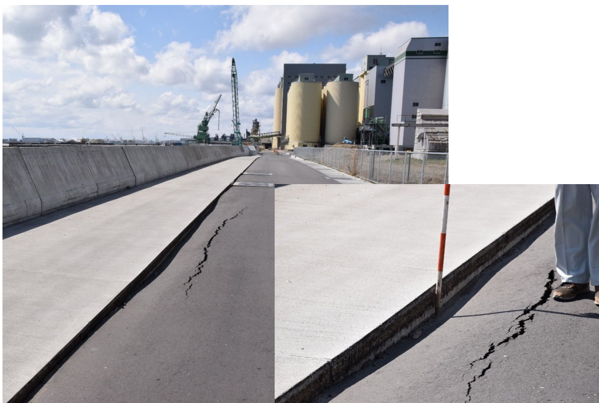
護岸背面の沈下および亀裂 ※噴砂は確認できず
