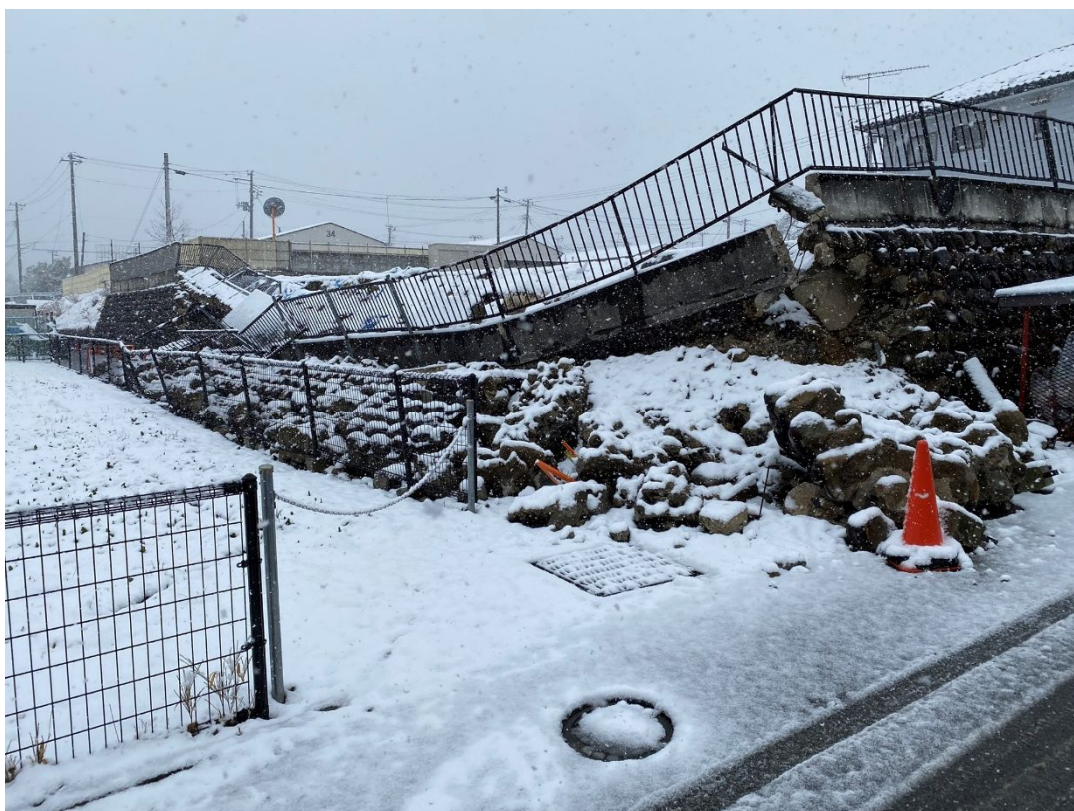
今回（2022年3月16日）の地震で擁壁が崩壊
