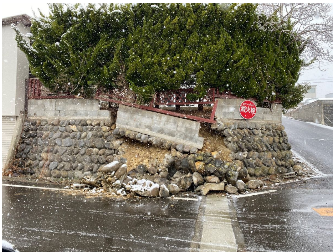
今回（2022年3月16日）の地震で擁壁が崩壊
