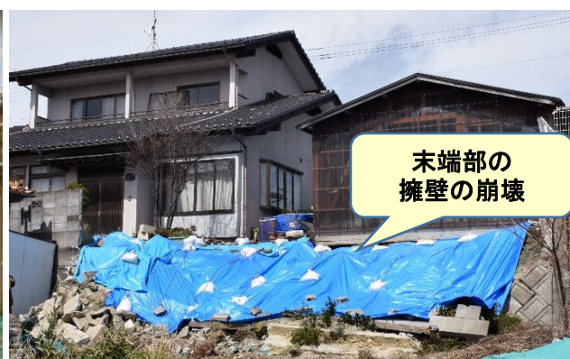
今回（2022 年 3 月 16 日）の地震後の被災状況
