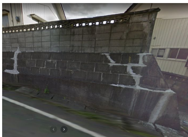
東日本大震災後の状況（2011年11月撮影） ※Google ストリートビュー
