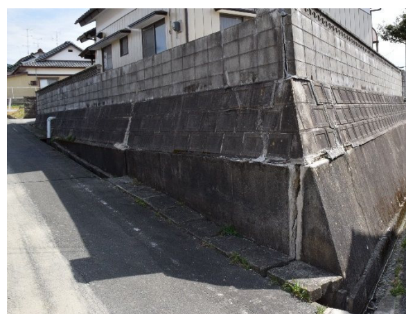
今回（2022年3月16日）の地震後の被災状況
