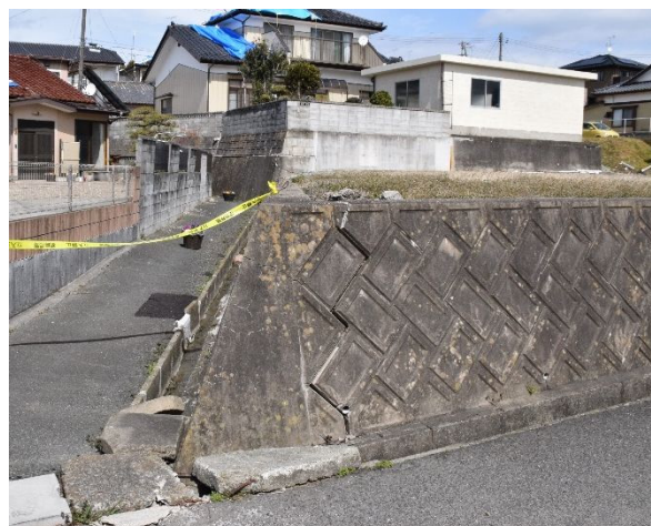
今回（2022年3月16日）の地震後の被災状況
