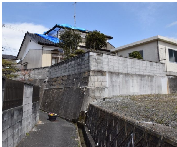
今回（2022年3月16日）の地震後の被災状況
