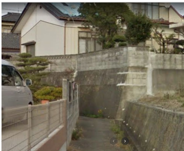
東日本大震災後の状況（2011年11月撮影） ※Google ストリートビュー
