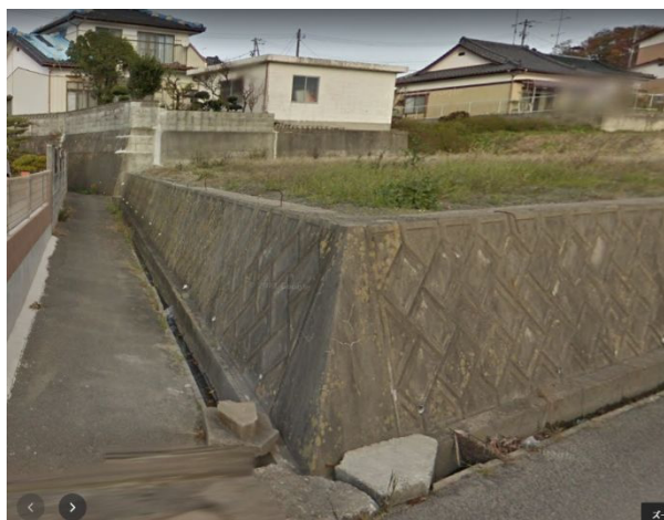
東日本大震災後の状況（2011年11月撮影） ※Google ストリートビュー
