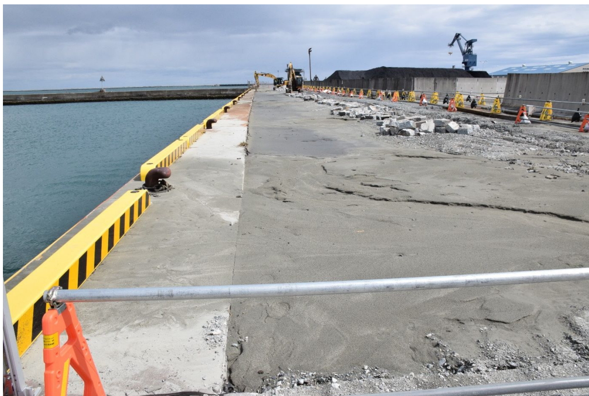
噴砂跡（岸壁は前面に押し出し）
