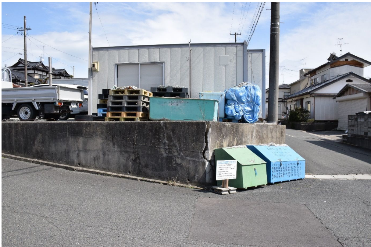
今回（2022 年 3 月 16 日）の地震後の被災状況
