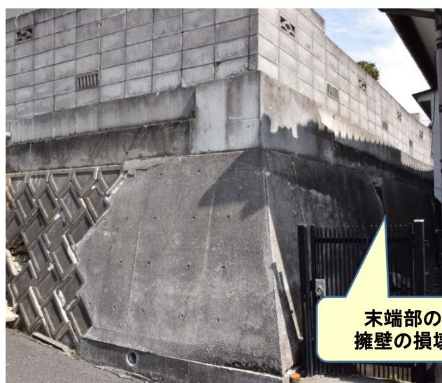
今回（2022 年 3 月 16 日）の地震後の被災状況
