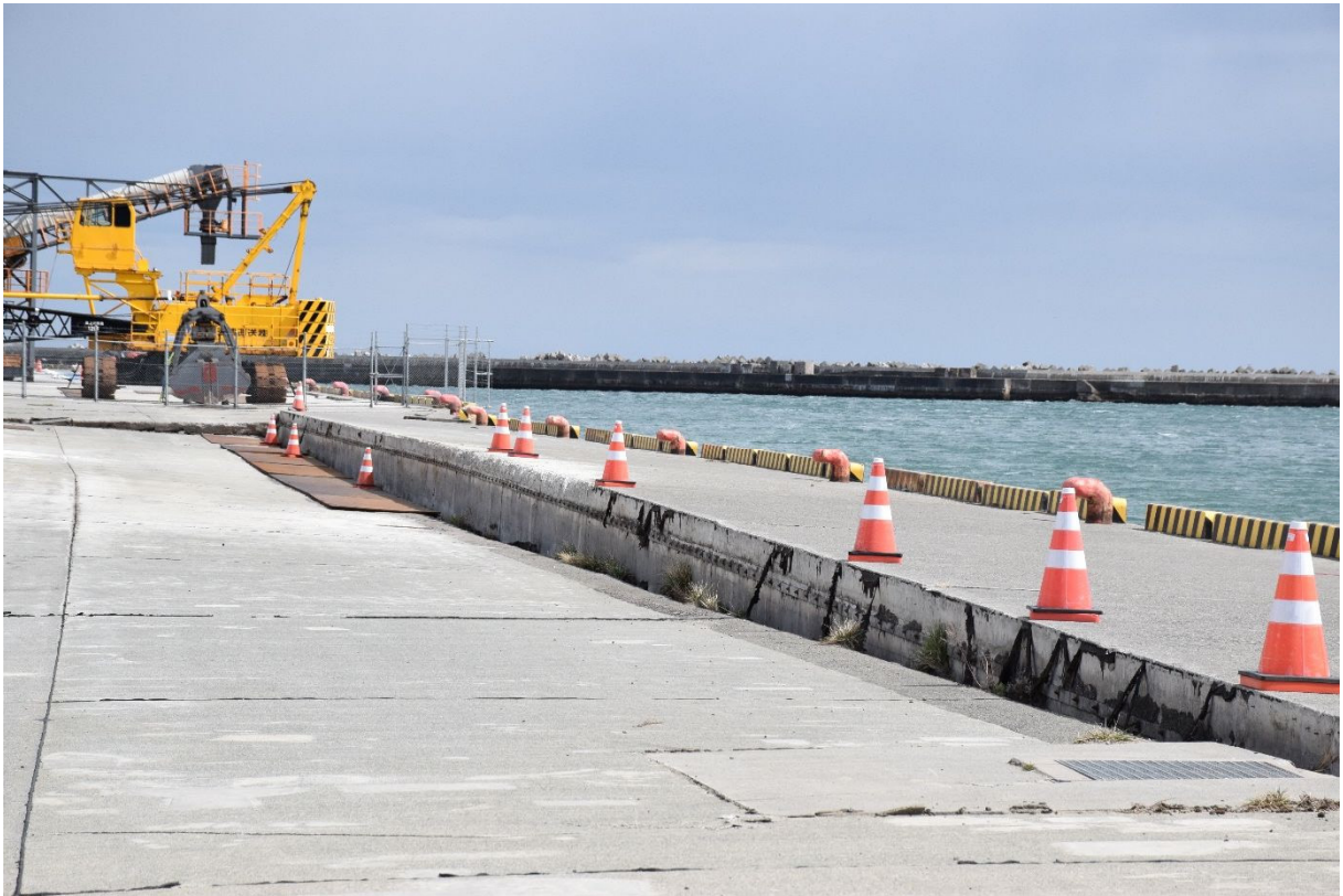
岸壁背面の沈下
