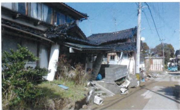
【写真1】地盤の側方流動による大規模な住宅被害
